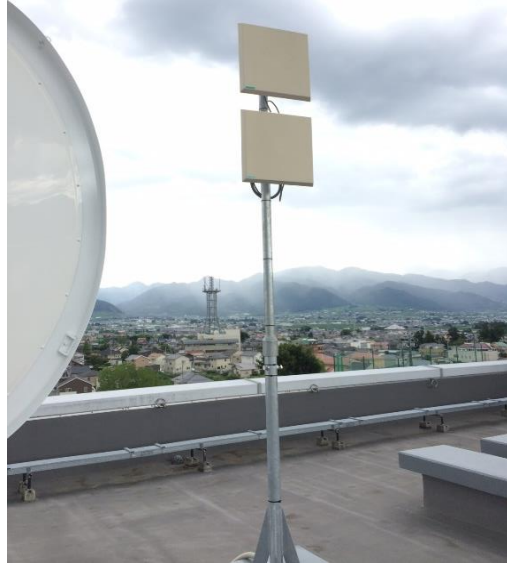
無線基地局（市役所屋上）
