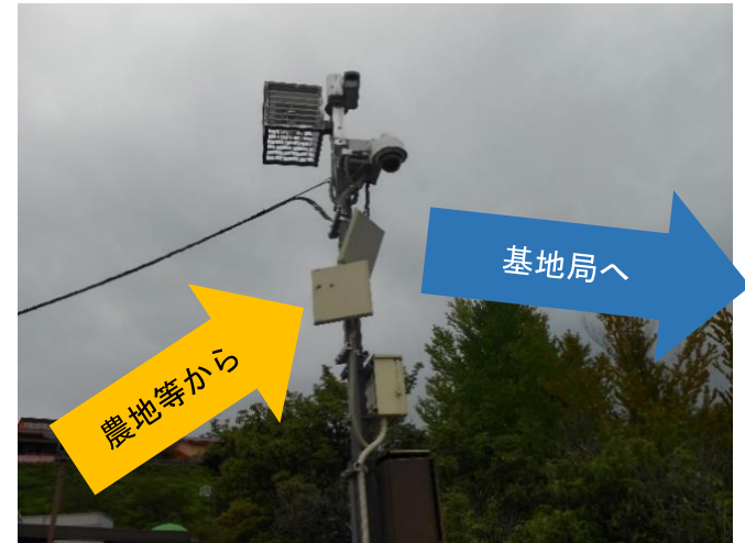
高台の無線中継装置（リピーター）
