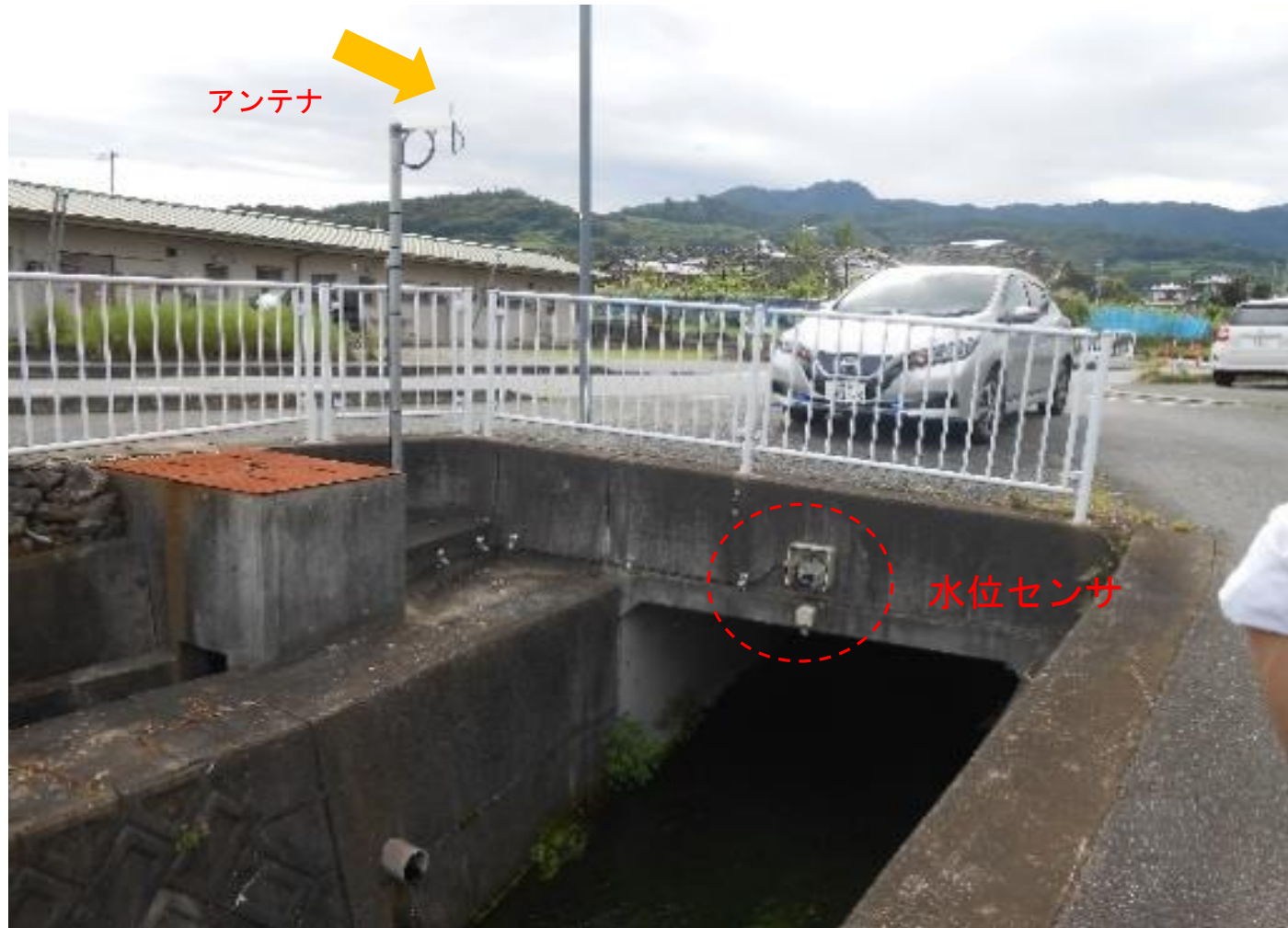
水位計（排水路）
